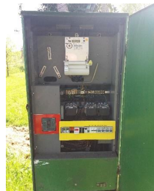
Rozvaděč RVO – VIIb
