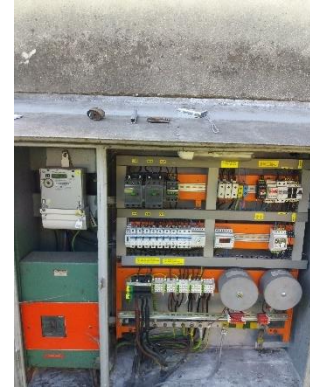
Rozvaděč RVO – IIIb
