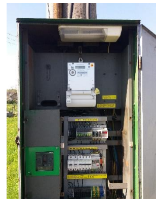
Rozvaděč RVO – VIb
